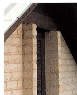
Ci-dessous: contrefort en saillie, au droit d'une ouverture, améliorant la stabilité du mur
